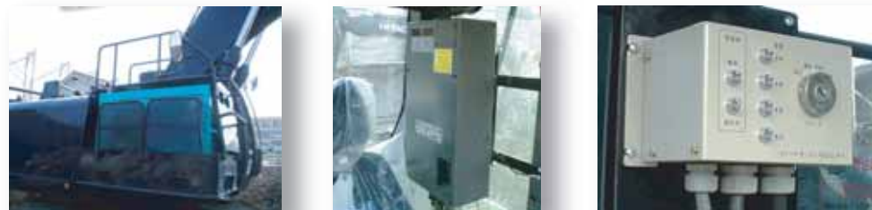
【写真】 左から、 エンジン式発電機 室内制御盤 室内発電機スターター
